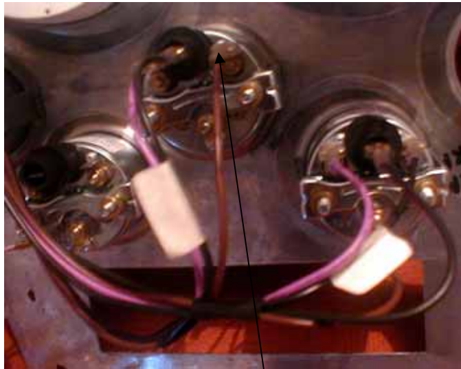
B- Volt meter brown Ground
